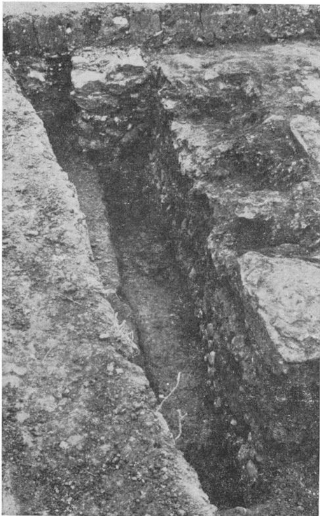
Фот. 6: Детаљ северног зида просторије 7 који се прислања уз северни зид просторије 2
